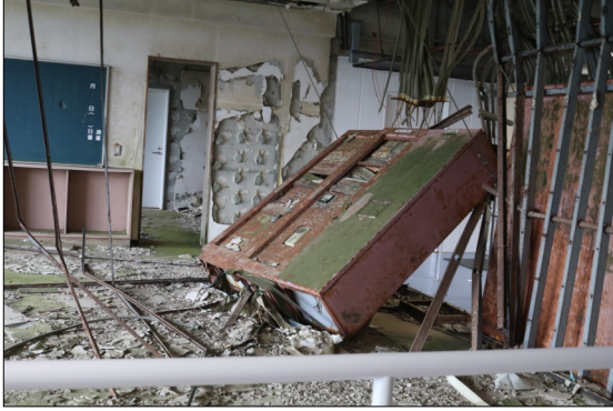
壁に設置されていた配電盤が引きはがされて横方向に倒れている。
