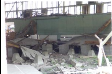
津波の傷跡・石巻市立女子商業高校体育館
